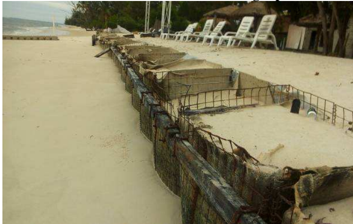
Photo n° 8 : Casiers fortement endommagés par la rouille
