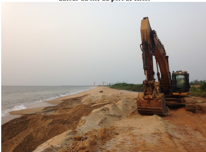
Photo n° 7 : Destruction par des engins des habitats côtiers sensibles autour du site du port de Kribi
